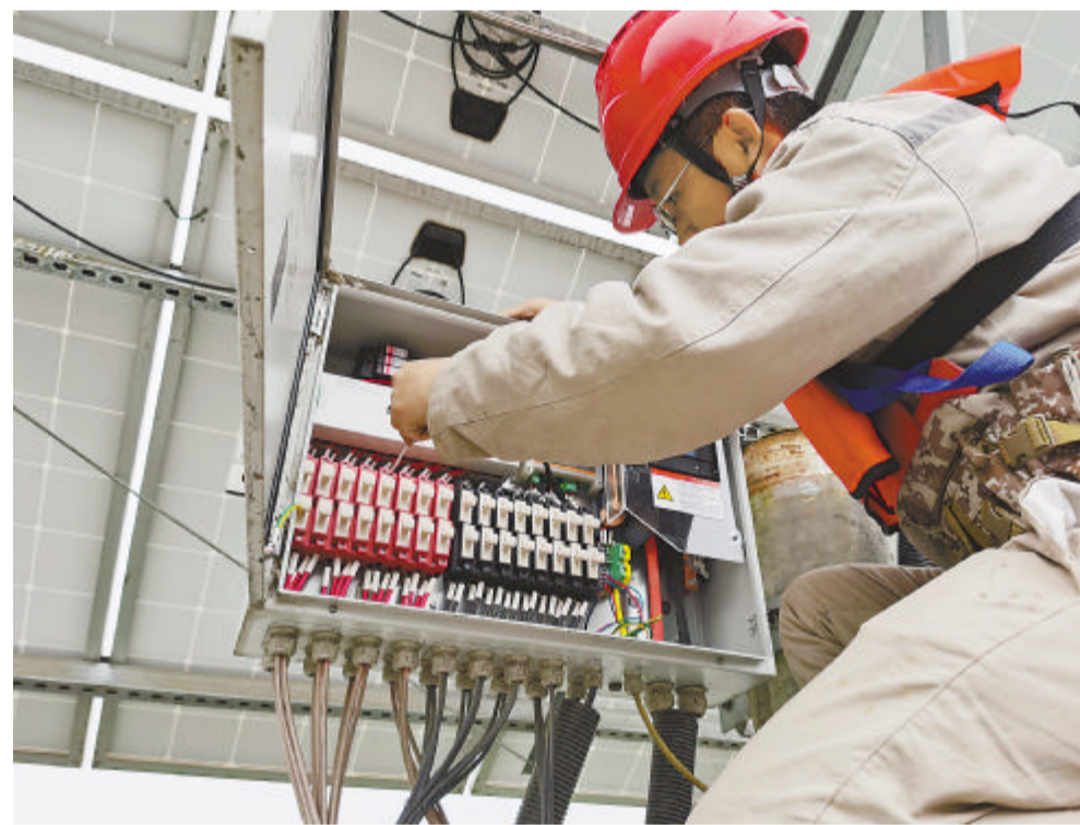
安徽长丰电站运维人员开展日常巡检
