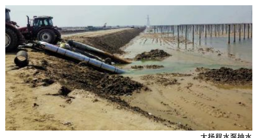
大扬程水泵抽水
