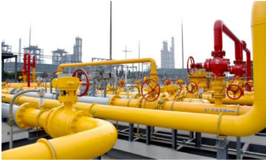
永祥股份燃气锅炉装置,实现零排放
